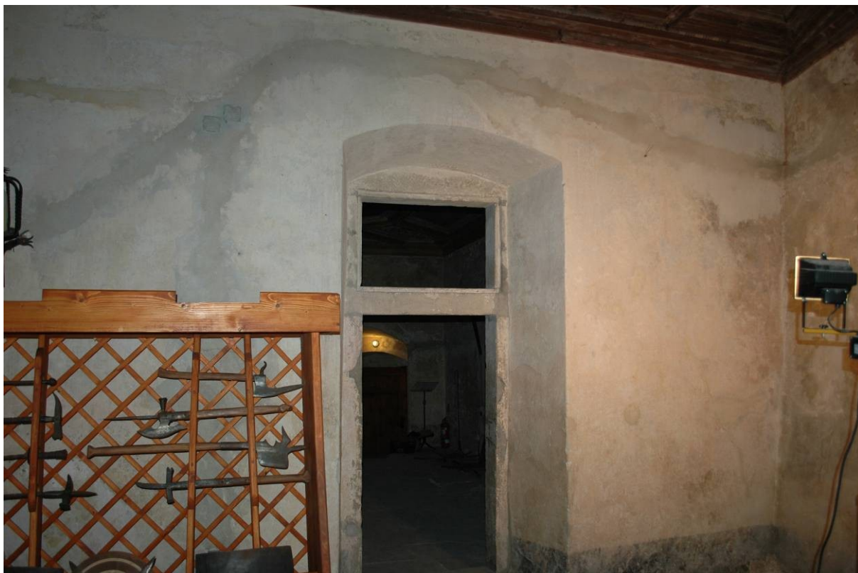
20. Miestnosť C, juhovýchodná strana, vedenie elektrických rozvodov.
