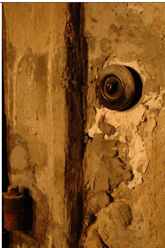
nevhodné cementové tmely
